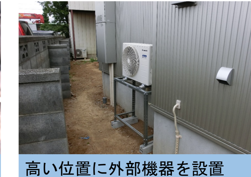
高い位置に外部機器を設置
