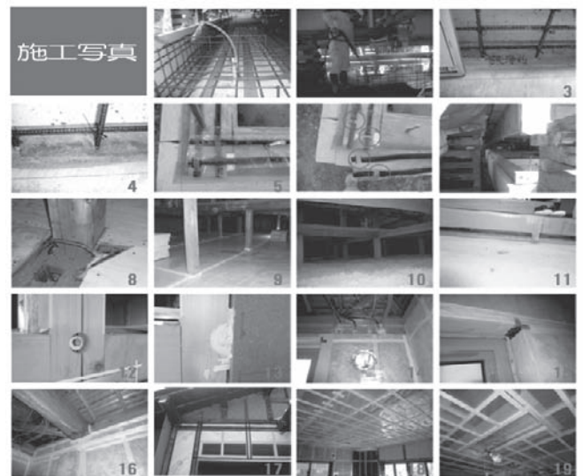
1・配筋 2・高圧洗浄 3・高圧洗浄前 4・高圧洗浄後 5・天端リスト 6・天端リスト 7・ジヤットアップ 8・丸太梁気密処理 9・天井気密シート 10・天井断熱(セルロースファイバー) 11・玄関扉下通気口 12・外周部ボルト熱橋処理前 13・外周部ボルトウレタン充填 14・配線気密 15・隅角部気密 16・充填断熱 17・充填断熱材と構造物材との間に気密パッキン 18・天井気密シート 19・天井照明ボックス
