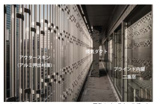
写真4. メンテナンスデッキ
